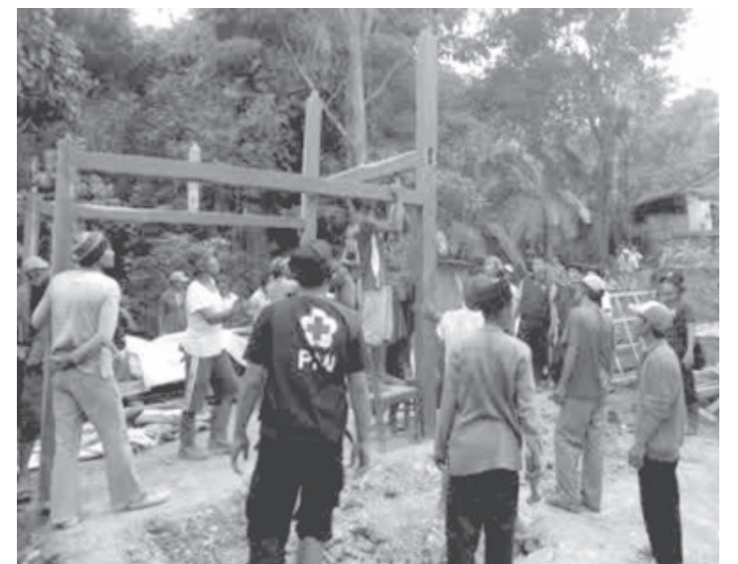
DIROBOHKAN - Anggota PMI dan warga merobohkan salah satu rumah warga yang rusak parah dan harus dirobohkan agar tidak membahayakan. SP/HASAN
