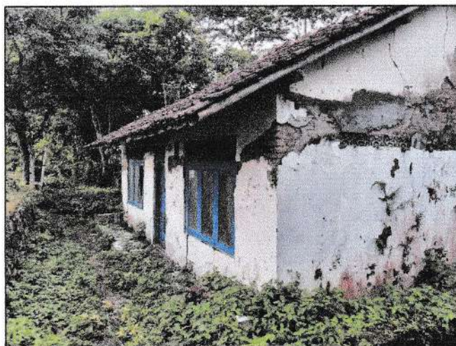
Foto 7. Kondisi rumah yang rusak di dekat tebing sungai, pemilik rumah sudah direlokasi oleh pihak desa.
