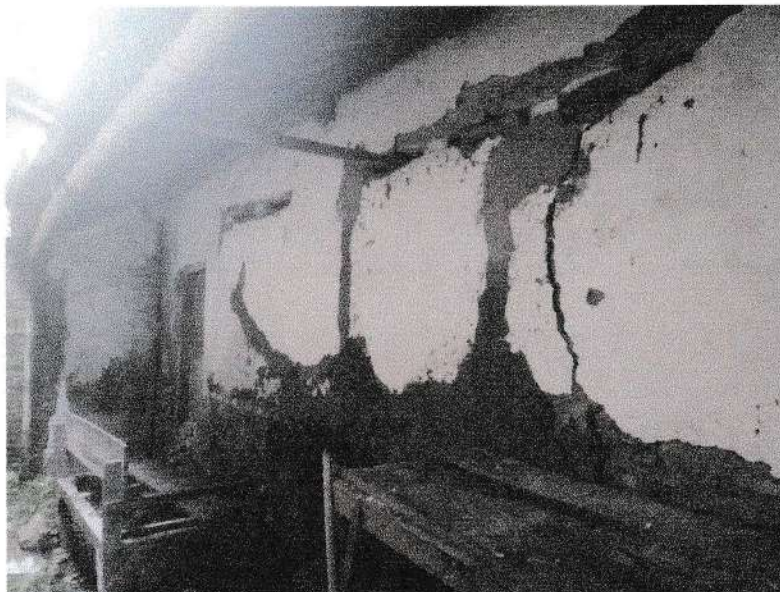
Foto 11. Retakan tembok rumah warga yang terletak di sempadan sungai, kerusakan juga dipengaruhi kualitas bangunan yang tidak memenuhi standar teknis bangunan.
