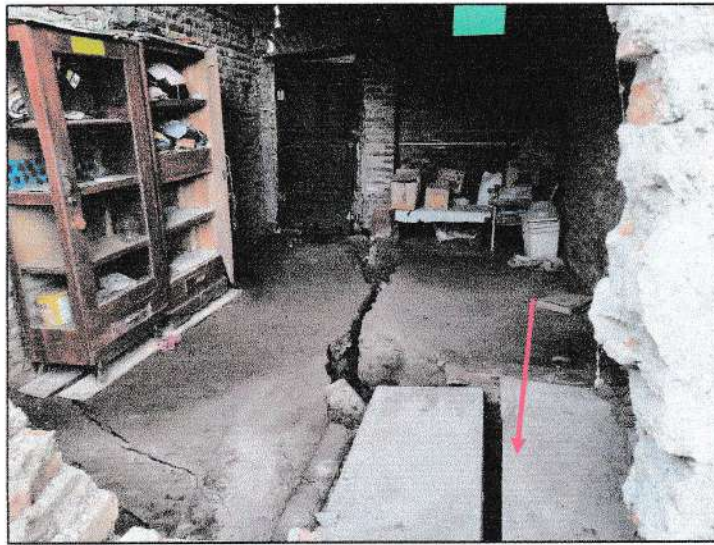
Foto 6. Rekahan tanah yang merusak rumah warga, rekahan tanah juga melewati sumur warga (panah merah) menyebabkan air sumur kering ( water loss ).
