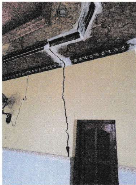
Foto 9. Retakan tembok mushola yang berada dekat dengan tebing sungai.
