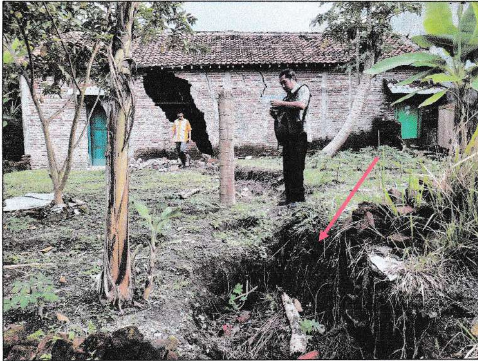
Foto 1. Rekahan tanah di tengah pemukiman (panah merah), rekahan memanjang membelah rumah warga yang berada di dekat tebing sungai.
