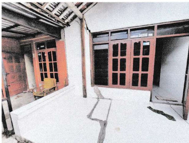
Foto 10. Retakan pada lantai dan tembok rumah warga, retakan pada lantai memanjang sampai belakang rumah.
